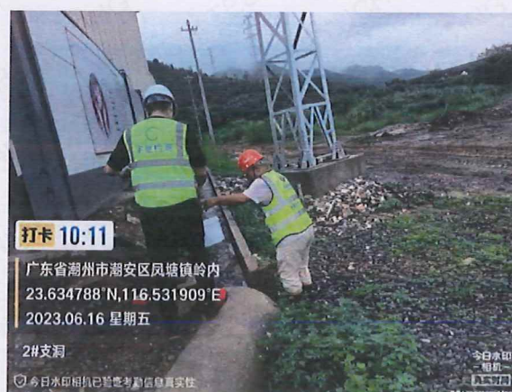
2#支洞隧道洞口排水
