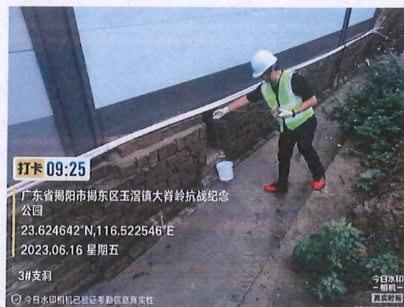
3#支洞隧道洞口排水
