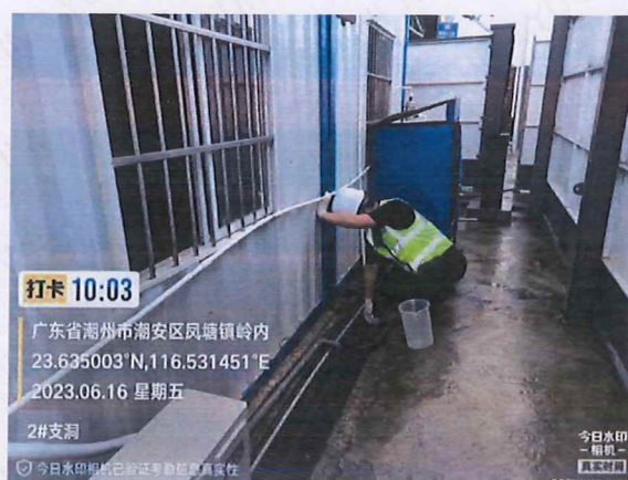
2#支洞生活污水
