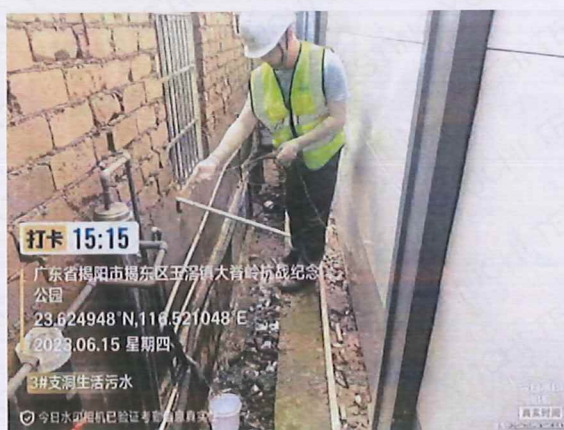
3#支洞生活污水
