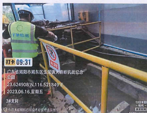
3#支洞生产废水
